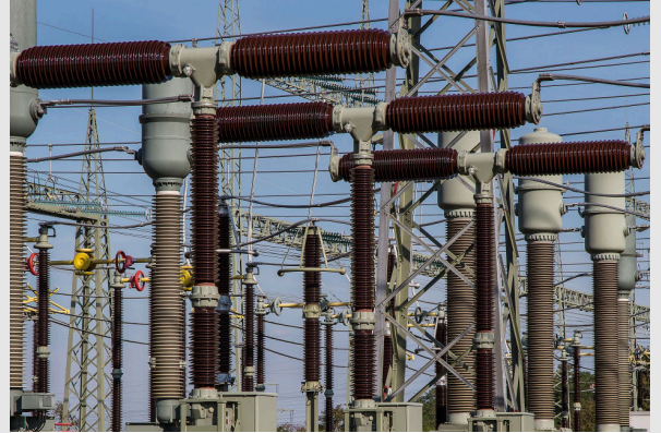
Transformadores de tensión
